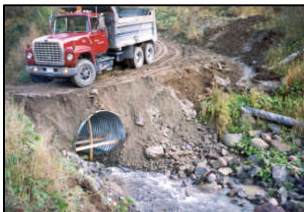
Traverse de cours d'eau créant de l'érosion (source : MRNF)
